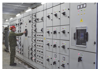
受変電設備異常検知
